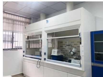
有机前处理室, 通风橱
